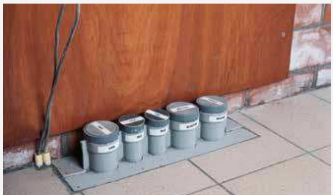
Toegangsopeningen van de aansluitbocht in de woning
